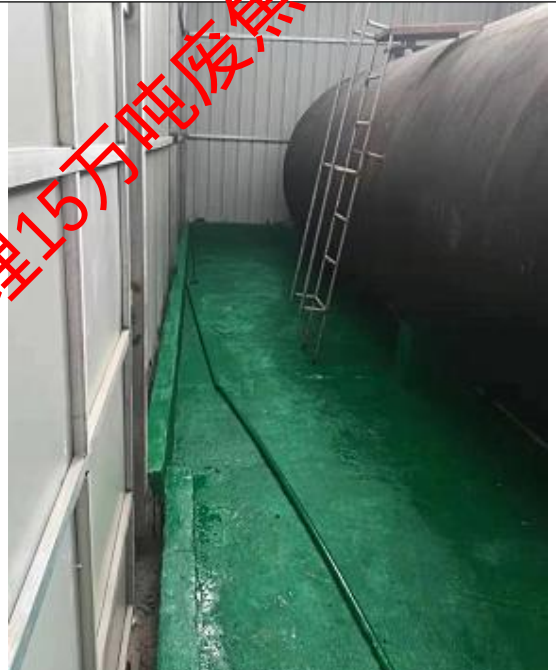
20m 3 柴油储罐围堰
