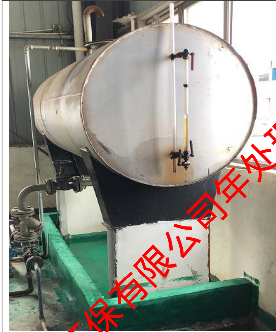
1.5m 3 柴油储罐围堰
