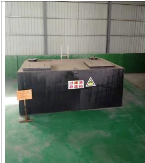
过滤渣收集罐
