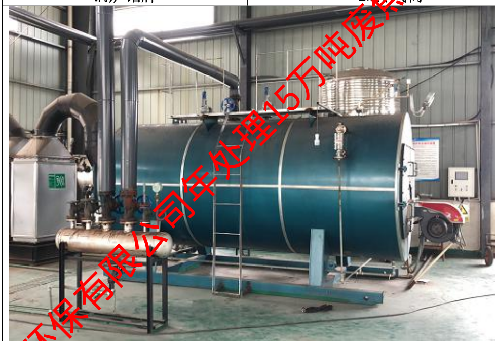
燃油蒸汽锅炉
