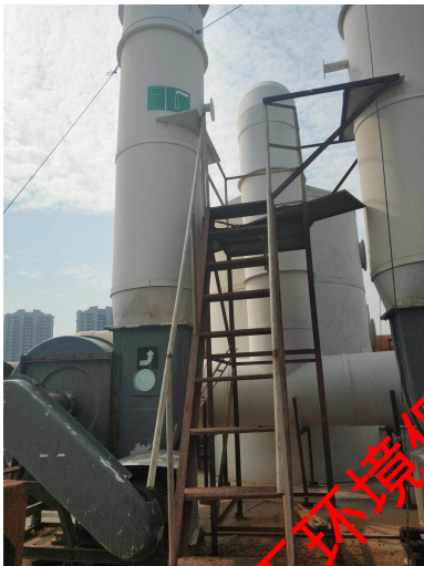
25m 高排气筒
