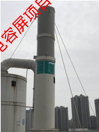
25m 高排气筒
