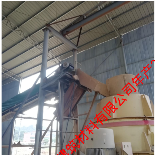
破碎机喷淋装置
