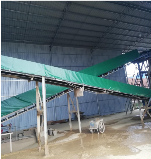
车间生产线密闭装置
